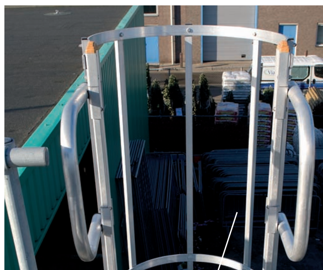
De daken van ONS: veilige werkplekken door permanente veiligheidsvoorzieningen
